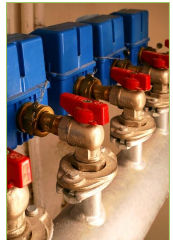
Ilustración 6. Contadores digitales de agua domiciliarios.
